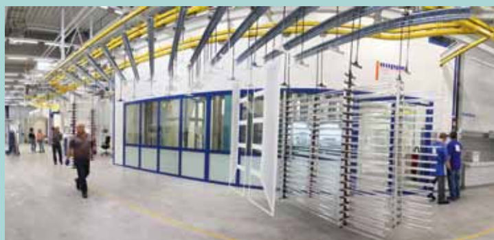
Il nuovo impianto di verniciatura della Groke a Karlsruhe è stato studiato dagli esperti con amore per i dettagli.
