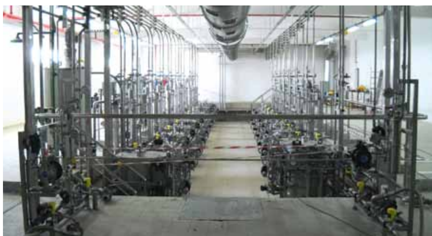
Sala di verniciatura principale dotata di pompe Maple 30 e 60.
